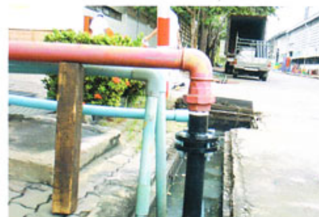
ใช้ในงานระบบดับเพลิง (Fire Protection System)
