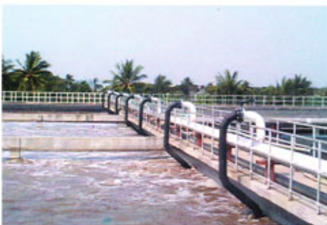
ใช้เป็นท่อน้ำทิ้ง และใช้ในระบบบำบัดน้ำเสีย (Sewerage and Wash Water System)
